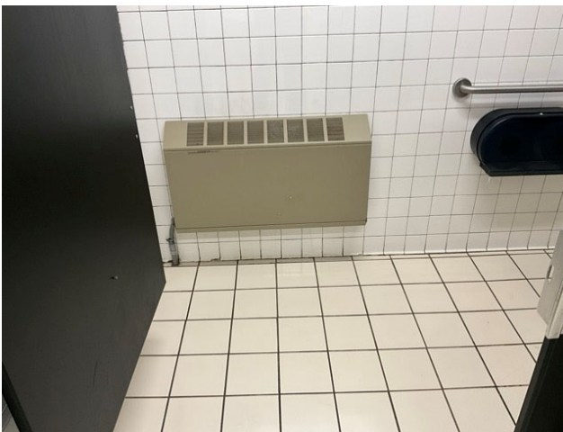
29 - FAN COIL UNIT
